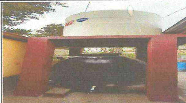
Foto 2: Tinaco instalado de tres capas de 1700 litros
